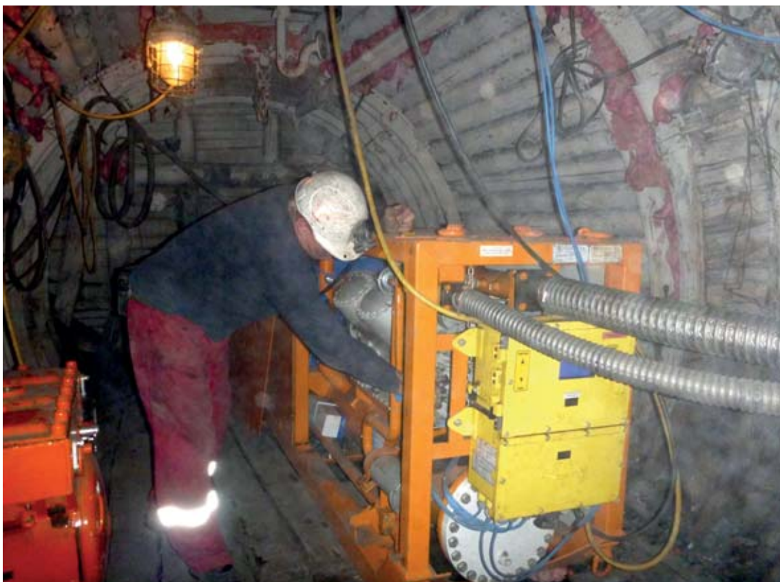
Overovanie novej klimatizačnej jednotky v 12. poli bane Handlová.
